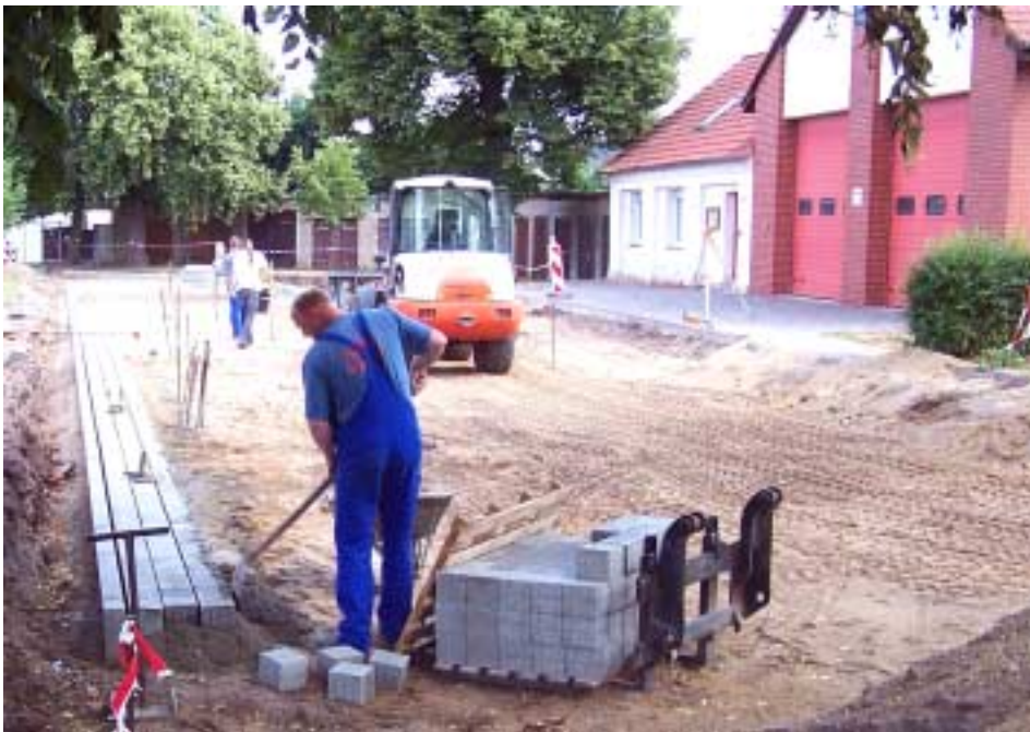
Im Juli begann der grundhafte Ausbau des Lindenwalles. Die Arbeiten sollen bis Ende August beendet sein.
